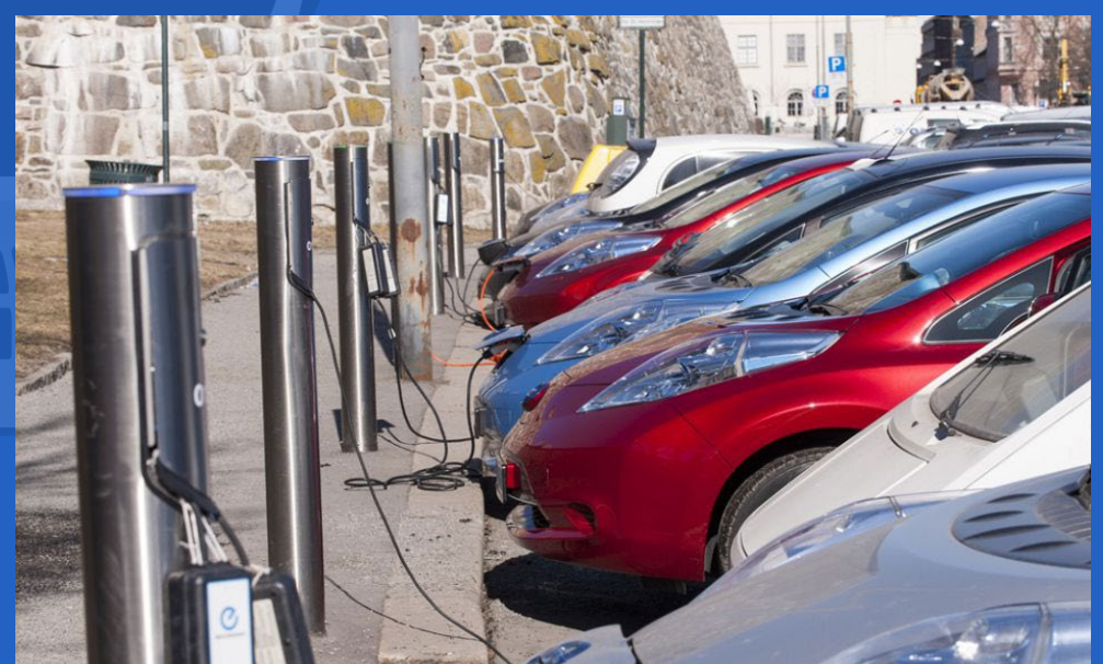
Fig. 2. Electrolinera para autos eléctricos
